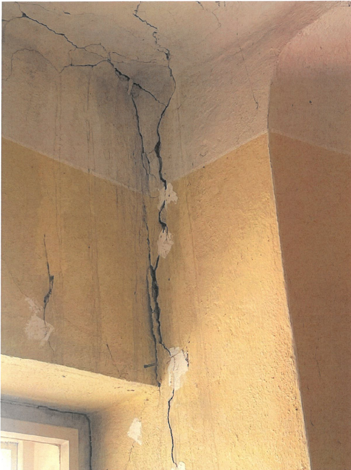
Shluk trhlin v oblasti nadpraží a fabionu
