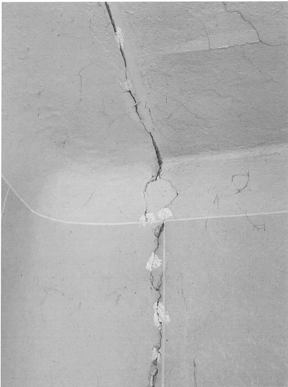
Trhlina objevující se na svislé stěně i stropě – zřejmě pracovní spára v rámci stavebního vývoje
